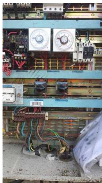
Armoire électrique de commande
