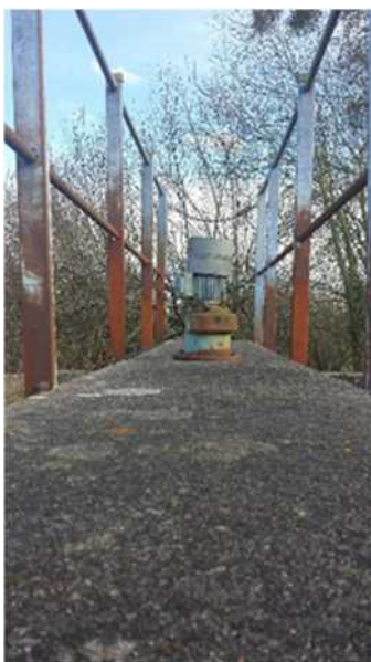
Turbine du bassin de traitement
